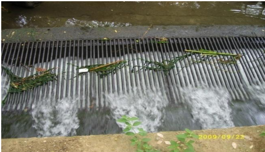
Figure 4 Bocatoma de fondo municipio de Palmira Rejillas. Fuente Aquaoccidente S.A E. S. P., 2021
