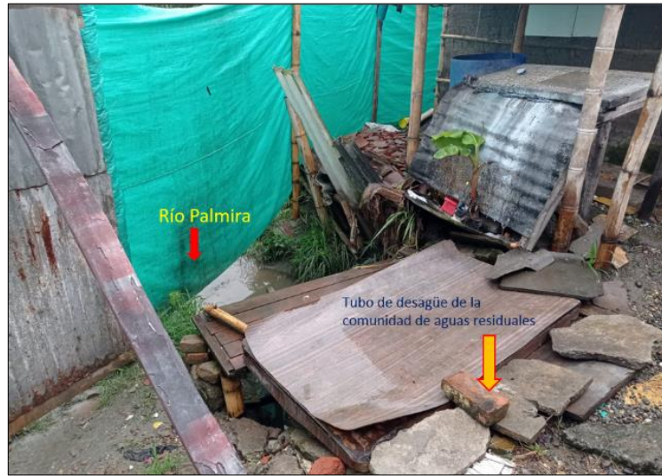
Figura 90. Zona de descarga del tubo de aguas residuales de la comunidad, localizada dentro del predio de la señora Ingrid Roa.
