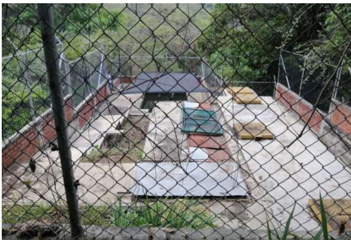
Imagen 7. Desarenado y filtración Asoacueducto El Taurete.
