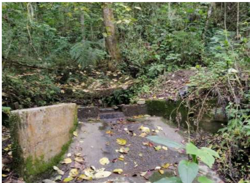
Imagen 5. Bocatoma, acueducto rural de Combia.
