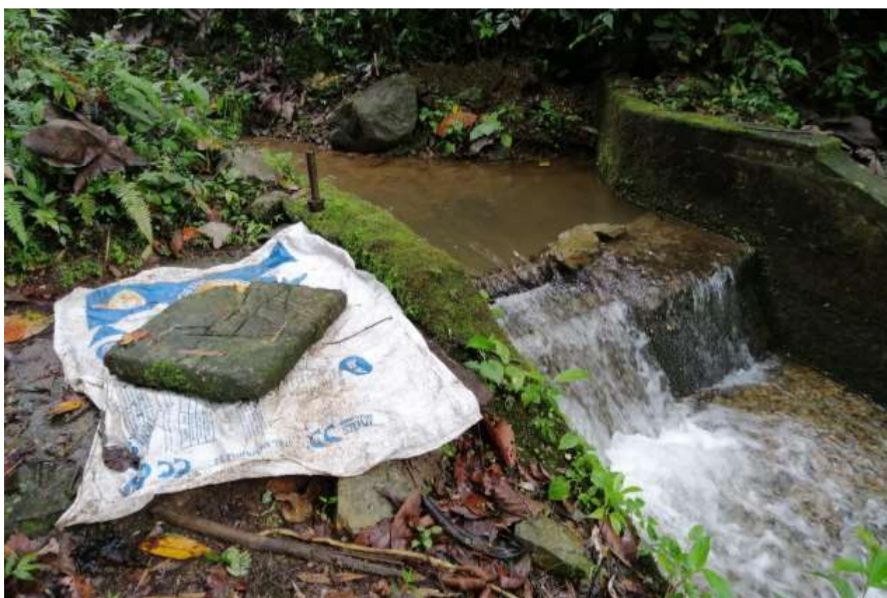
Imagen 4. Bocatoma del acueducto rural comunitario de Potrerillo.
