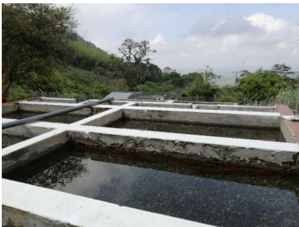
Imagen 1. Acueducto y Alcantarillado de Ayacucho La Buitrera E.S.P (Desarenador).
