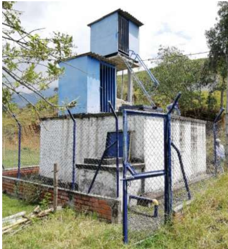
Imagen 2. Planta de cloración y tanque del acueducto rural Acuaarzap.
