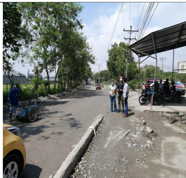
Mal estado de la vía y redes eléctricas que consolidan esta vía, localizada en un área privada.
