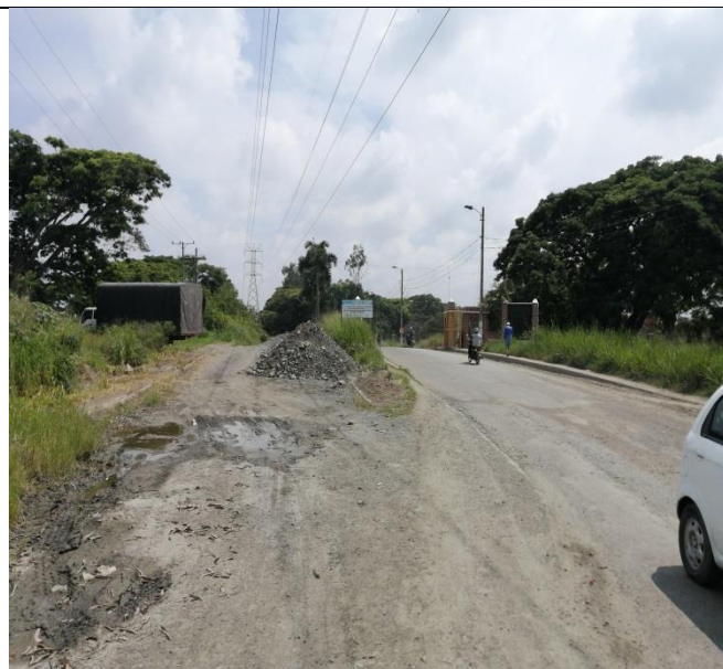
Se observa la portería de acceso a ciudad del campo, con vía en mal estado.
