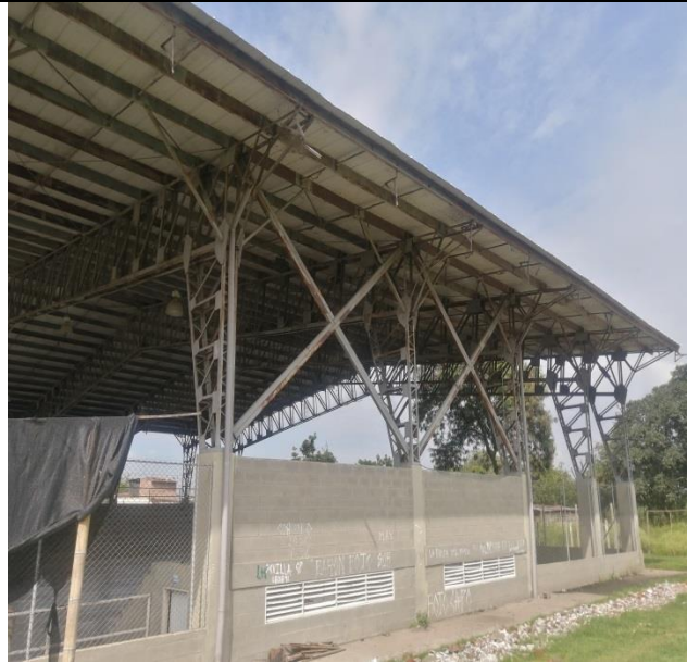
Los huecos ocasionados por la caída del agua lluvia. Están siendo rellenados con escombros, produciendo deterioro en la cancha de fútbol.
