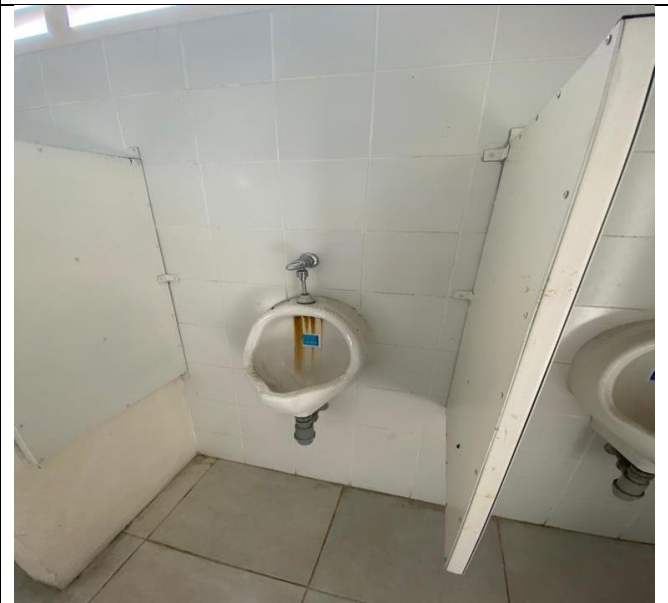
Deterioro en baños, no hay mantenimiento correctivo.
