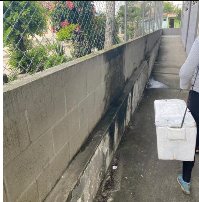
Daño en pintura y deterioro de pisos en concreto.
