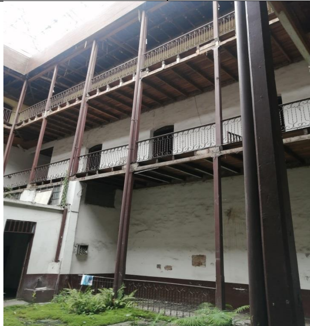
La madera de las columnas ya se encuentra a la intemperie.
