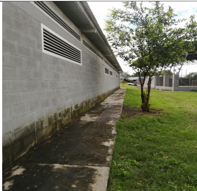
Deterioro en muros y pisos por no control de aguas lluvias.
