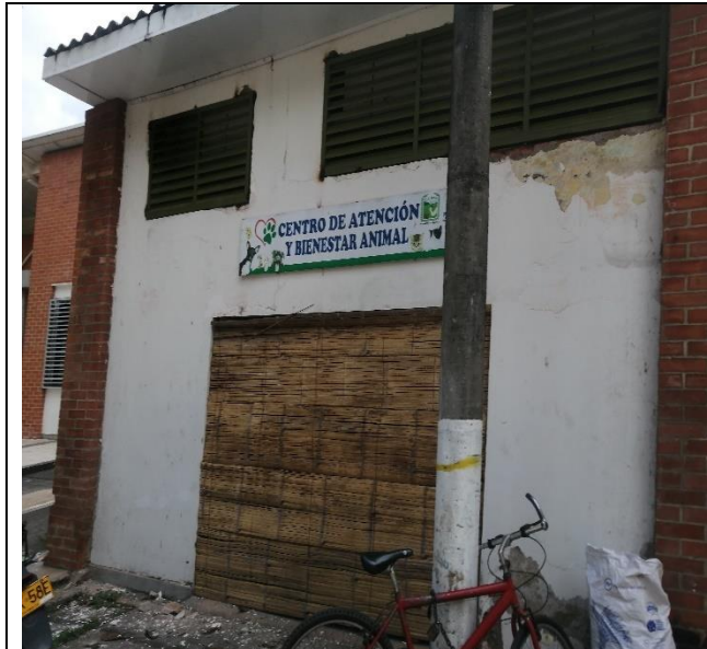
Daño en la fachada, pintura, estuco y carteras de vanos.
