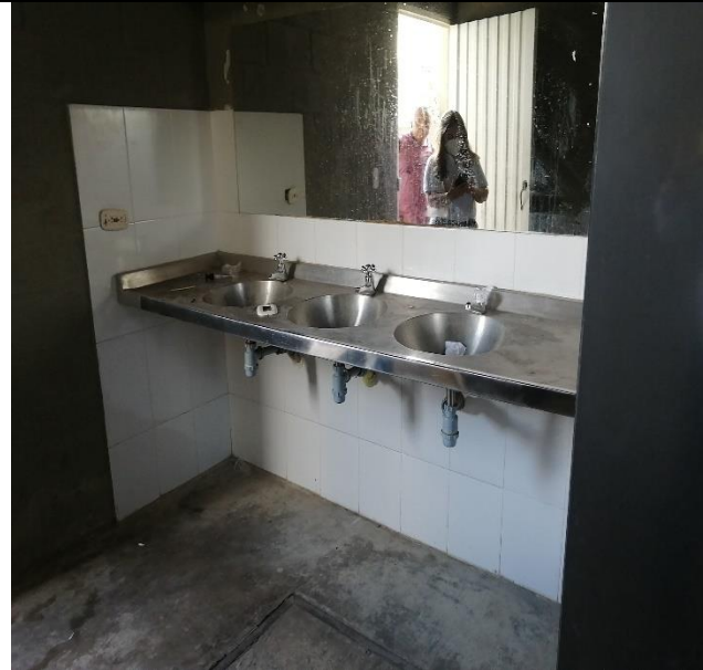
Se debe de revisar las instalaciones hidráulicas grifos y desagües sin funcionar.
