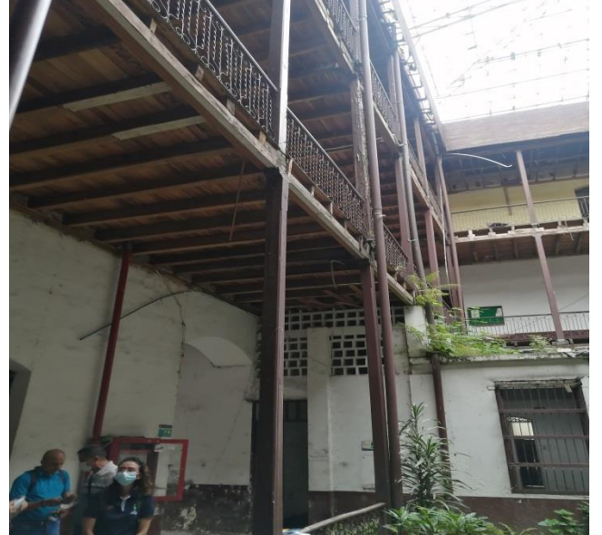
El vandalismo o perdida de las puertas.
