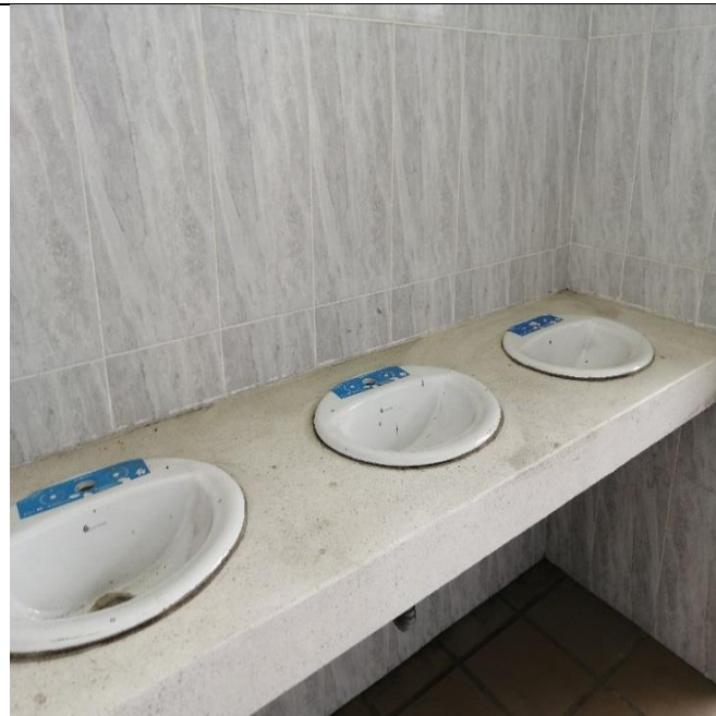
Vandalismo y hurto de los grifos de los lavamanos.
