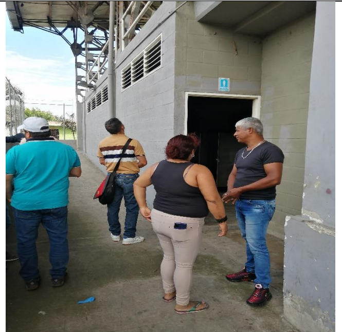
El acceso a los camerinos está muy deteriorado en ítems como pintura muros, persianas y naves metálicas de las puertas.
