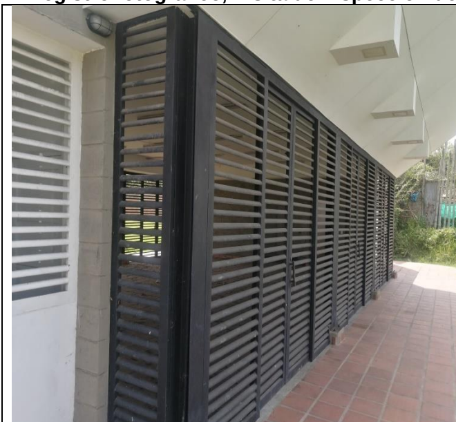
Deficiencia de mantenimiento de la fachada en persiana metálica, presenta deterioro.
