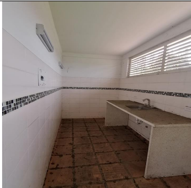
Falta de aseo, deterioro en mesones y pisos
