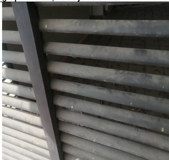
Detalle del deterioro en la fachada persiana metálica.
