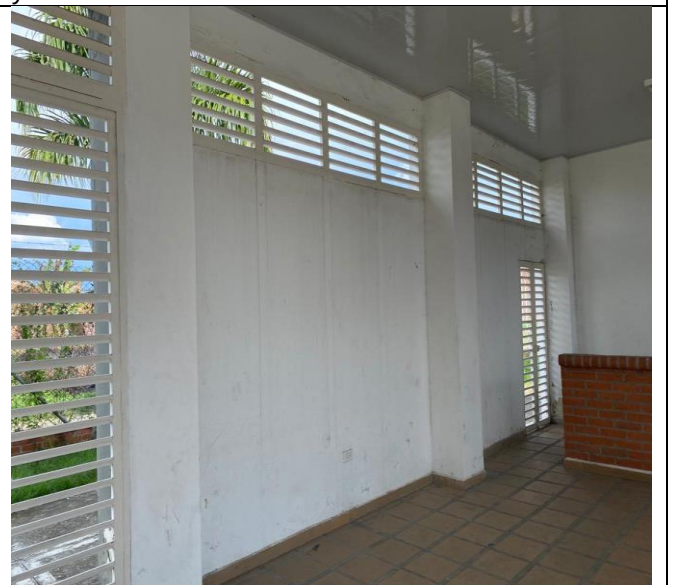
Deterioros en muros y pisos, por falta de aseo y mantenimiento correctivo.
