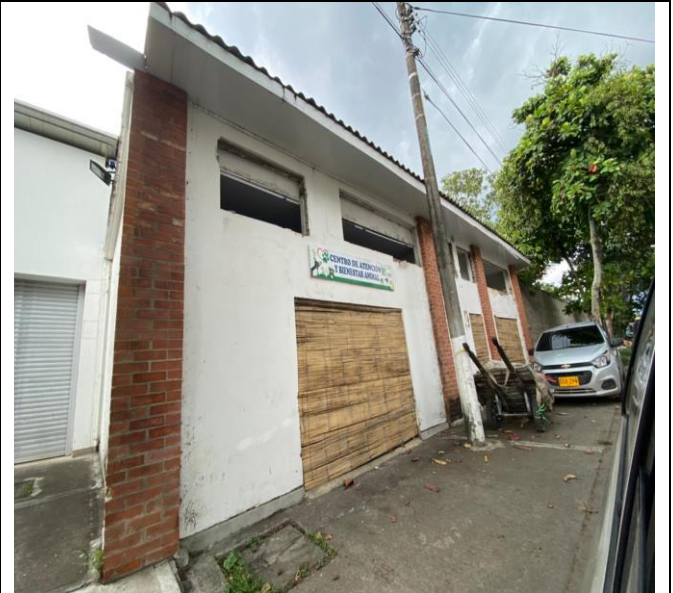
El vandalismo o perdida de las puertas.
