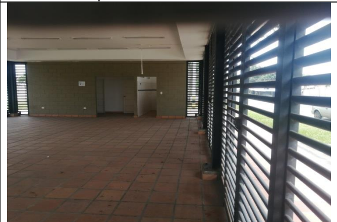
Pisos y persiana metálica deteriorados.
