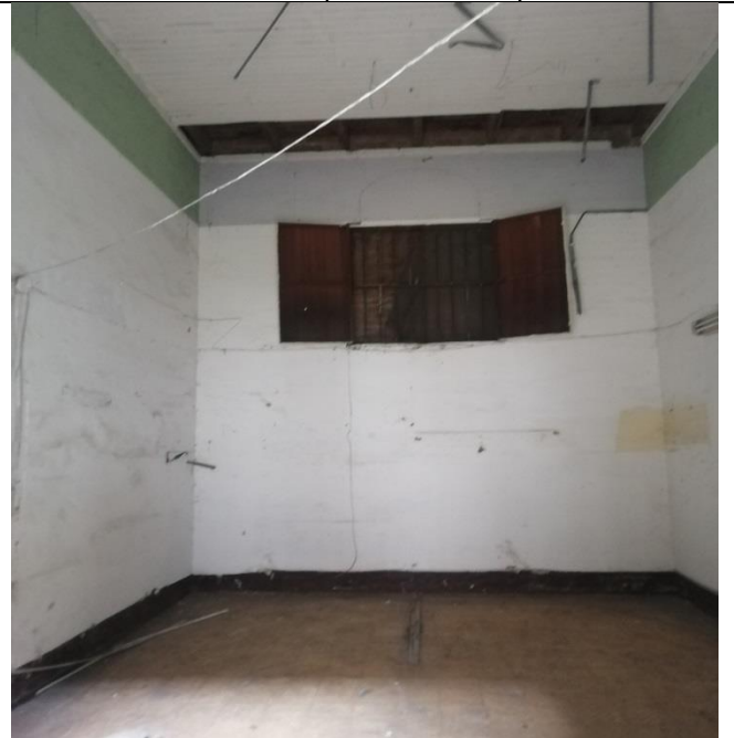
Evidencias de deterioro en muros y pisos.
