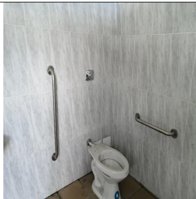
Deterioro y falta de mantenimiento
