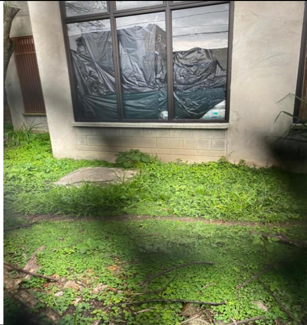
No hay control de la maleza, lo que produce humedades en los muros.
