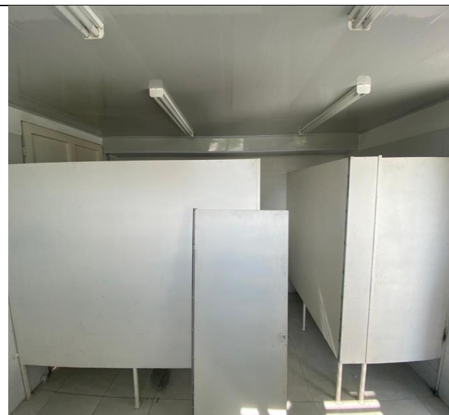
Divisiones de baño deterioradas, sueltas y aun no utilizadas para su objetivo.
