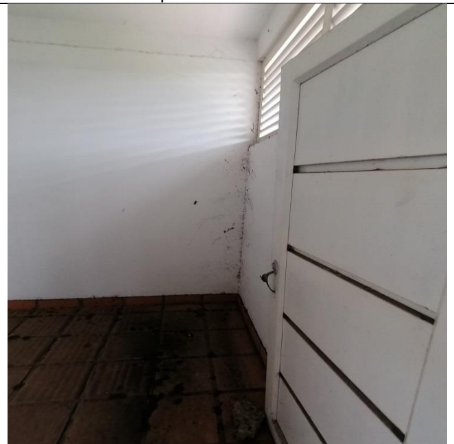
Deterioro en la mampostería y en la nave metálica de la puerta del salón principal.
