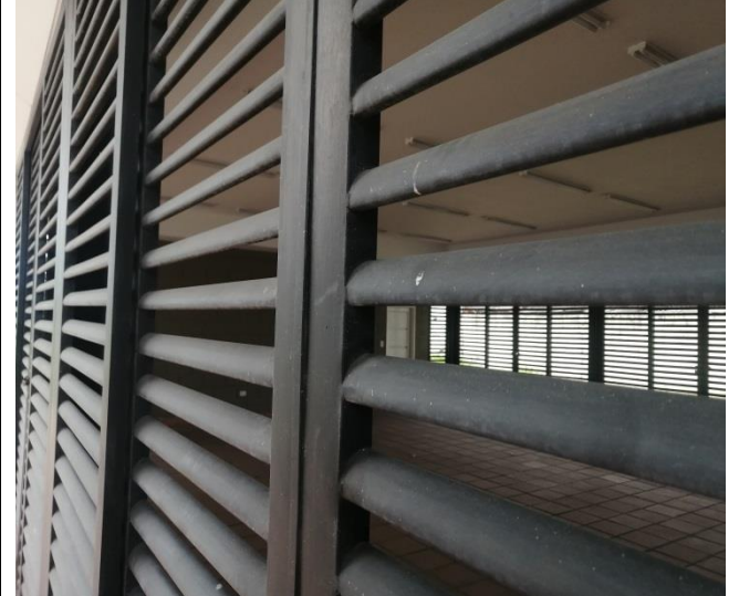
Estado de deterioro de la periferia metálica, en partes se presenta señales de óxido.
