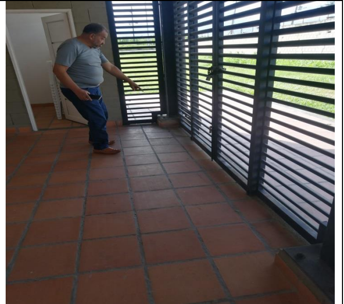
Deterioro en persiana fachada, oxido en sectores.
