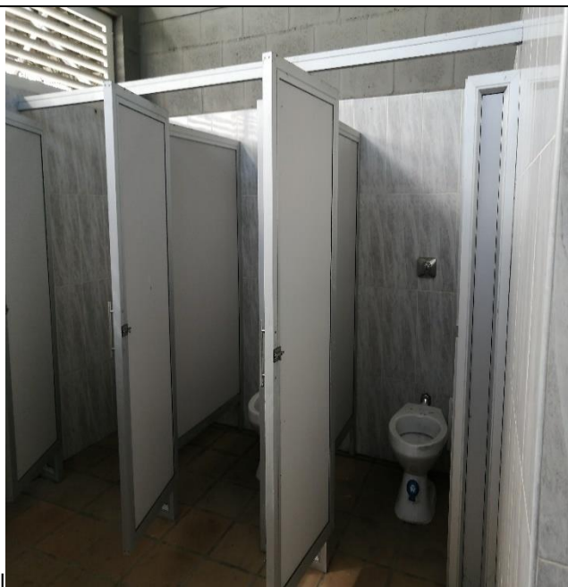
Deterior de los baños en conjunto
