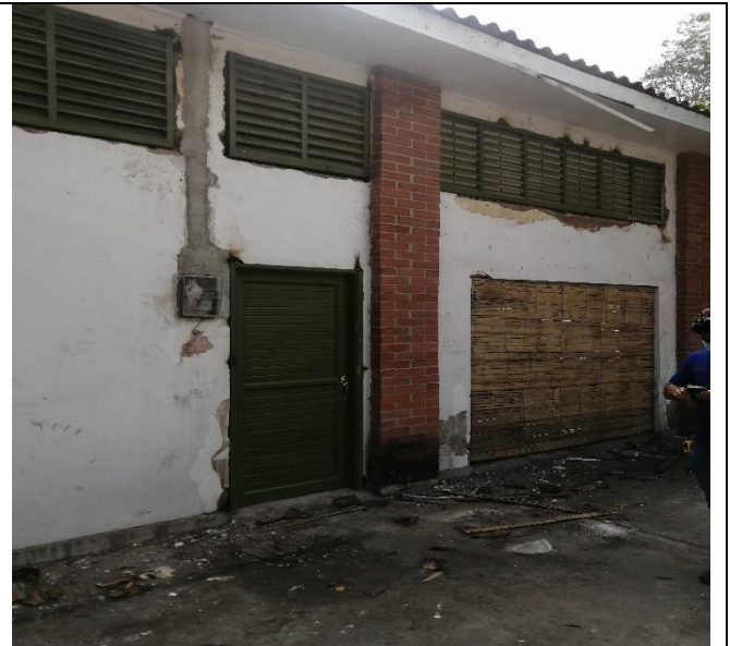
Humedades en el zócalo de la fachada.
