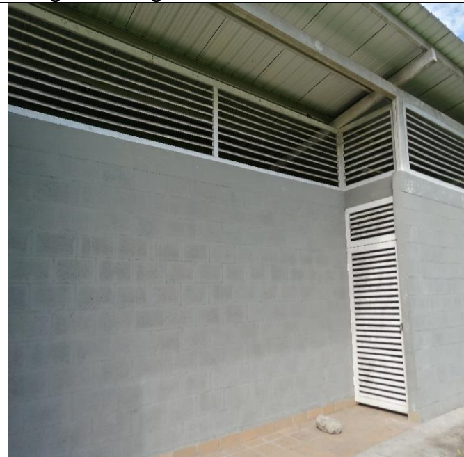
Deterioro lucetas tipo persiana, por humedad y deficiencia en el mantenimiento.
