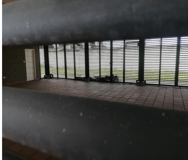
Estado de deterioro en pisos, Equipamiento utilizado por habitantes de la calle.
