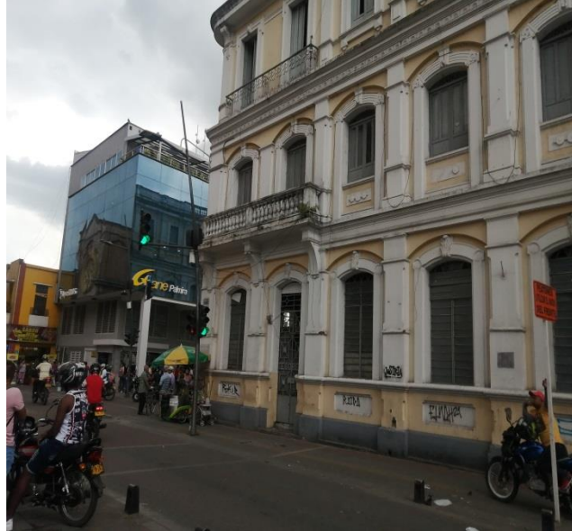
Elementos de fachada presentan deterioro.
