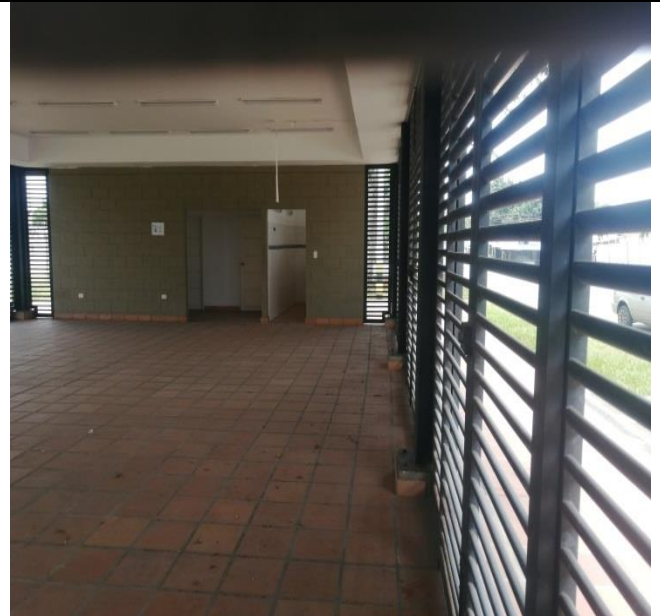
Deterioro en pisos y cielo.
