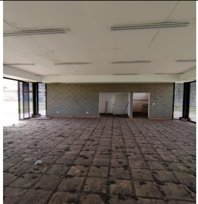
Deterior del piso en tablón, ausencia de mantenimiento y aseo
