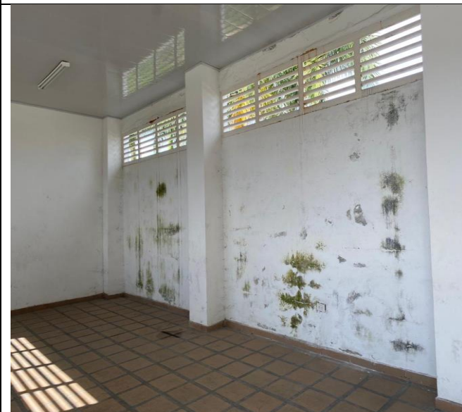
Deterioro causado por humedades en los muros, no hay protección de la fachada.
