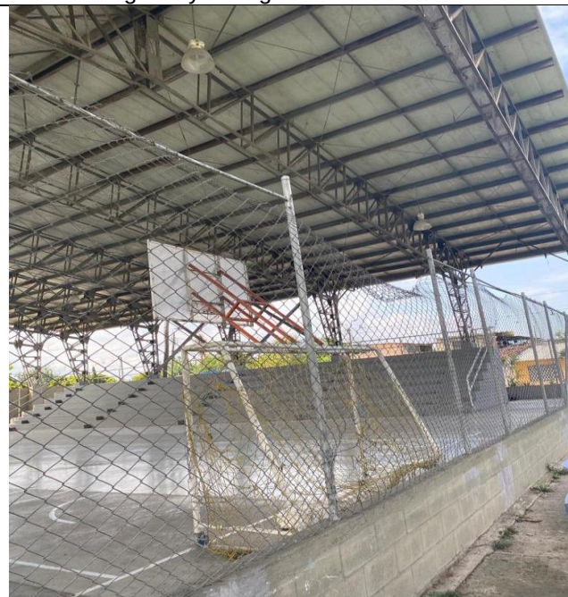
Lado norte del CIC se encuentra sin canal, fue levantada, las aguas lluvias caen al terreno verde, socavando gran parte de esta área.
