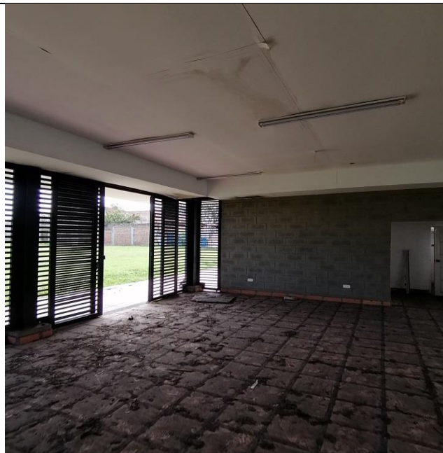
Deterioro en panel yeso de la cartera perimetral
