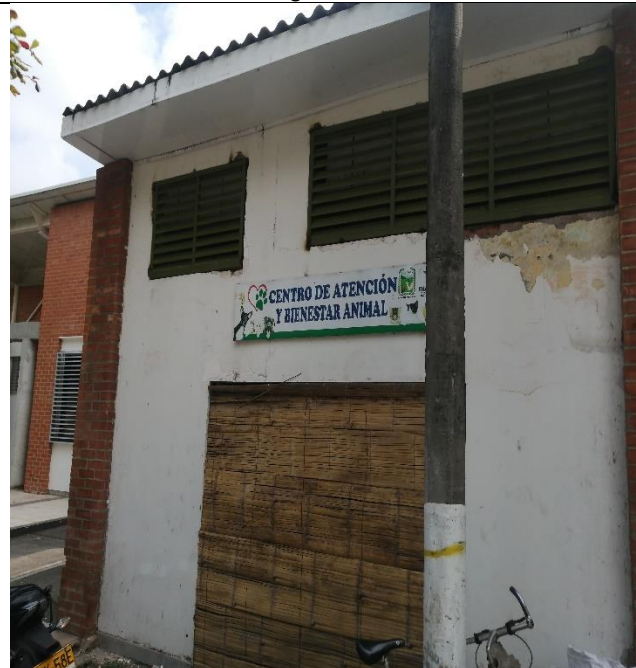
Estado de la fachada totalmente deteriorada, estuco, pintura, vanos de puertas y ventanas.
