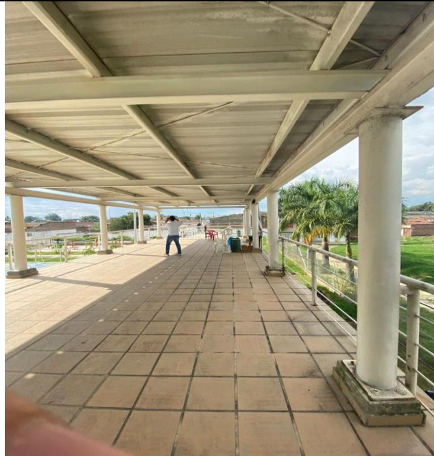
Estado de deterioro de los pisos en este caso del tablon, cubierta corta, sin protección en las barandas y fachadas.
