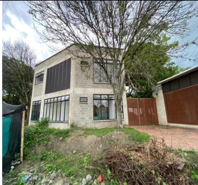
Escombros, maleza y un cerramiento deficiente, lo que puede incidir en el estado físico de la edificación.
