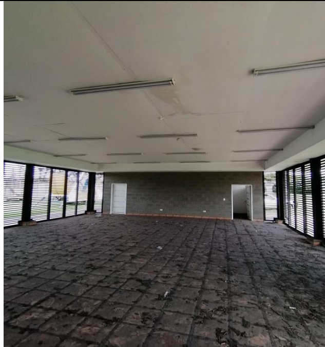
Deterioro de cielo falso en panel yeso
