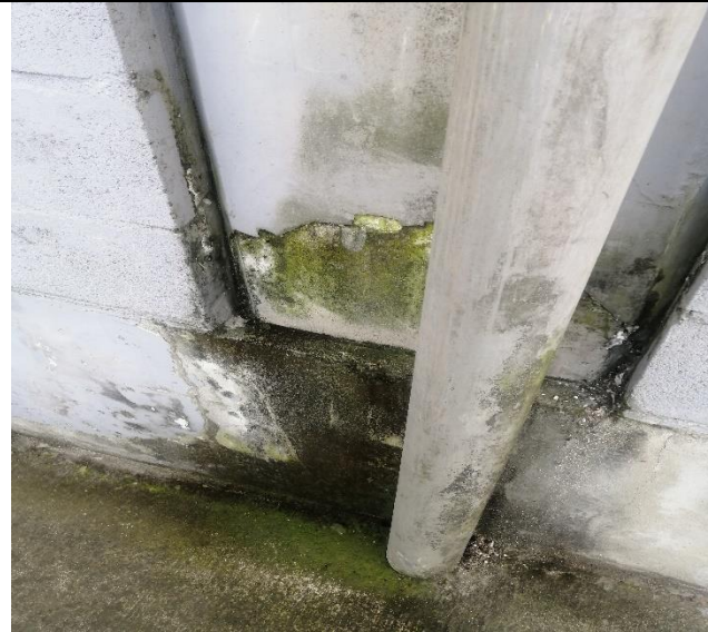
Daño en muros y piso, ocasionada por la filtración de las aguas lluvias del bajante.
