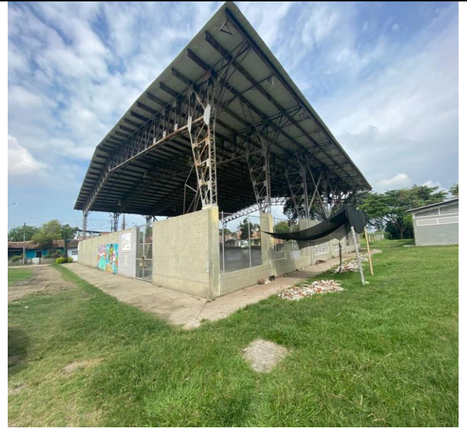
Deterioro área rellenada con escombros. En el lado contiguo hay un muro en peligro de colapsar
