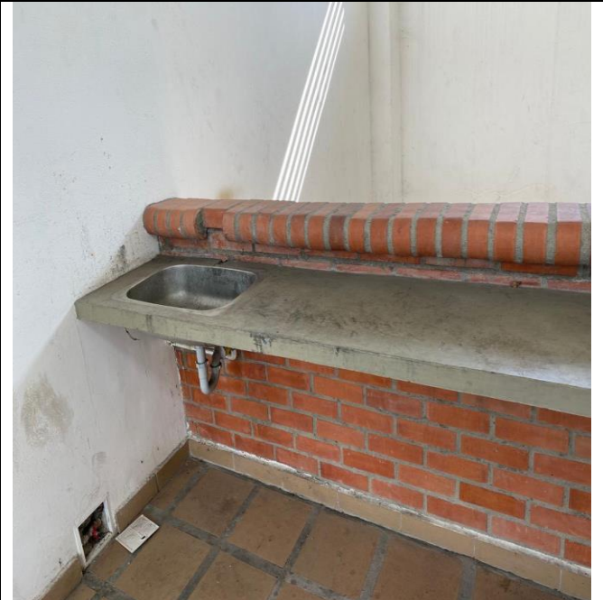
Estado de deterioro en cocineta, perdida de grifos, deterioro en muros y en caja de paso.
