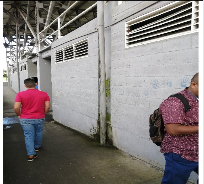
Humedades, daños y deterioro en persiana metálica tipo luceta, afectación de piso y muro.
