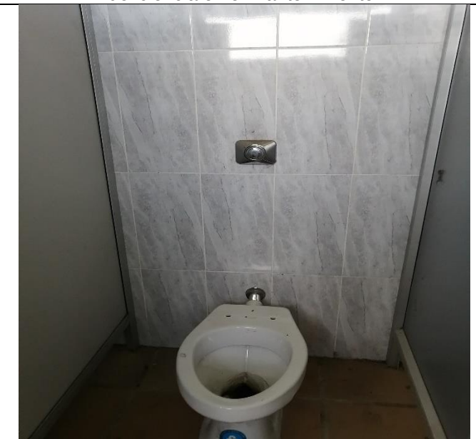
Vandalismo y hurto de las tapas del sanitario, deterioro en los pisos y aparato sanitario.
