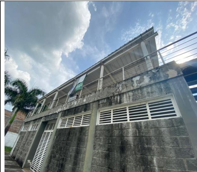
Estado del deterioro la fachada, no hay proyección de la cubierta.
