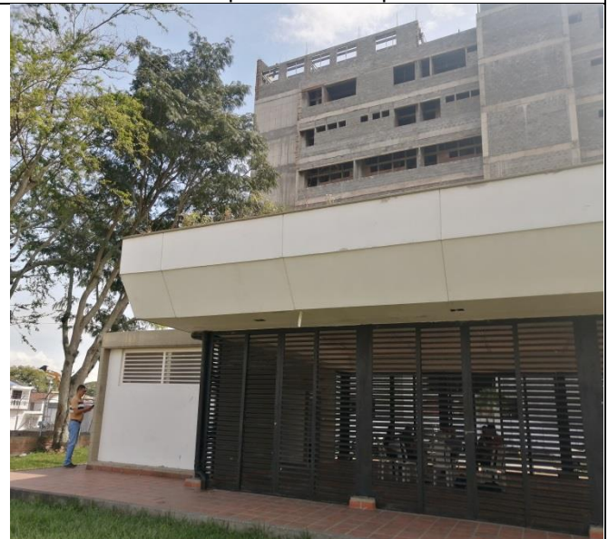
Detalles de deterioro en fachada superior de superboard.
