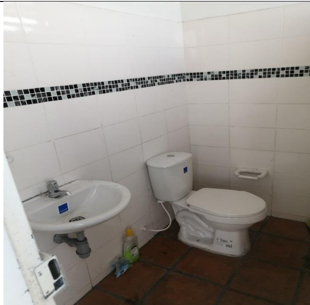
Baños deteriorados por falta de limpieza y mantenimiento, pisos con juntas deterioradas.
