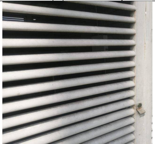
Puerta en persiana metálica sin mantenimiento con señales de óxido.
