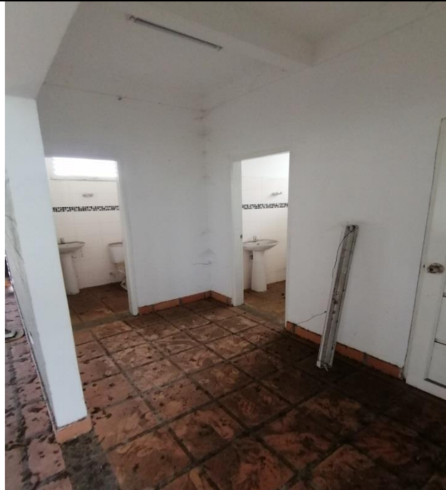
Deterioro en pisos, caída de lámpara de iluminación.
