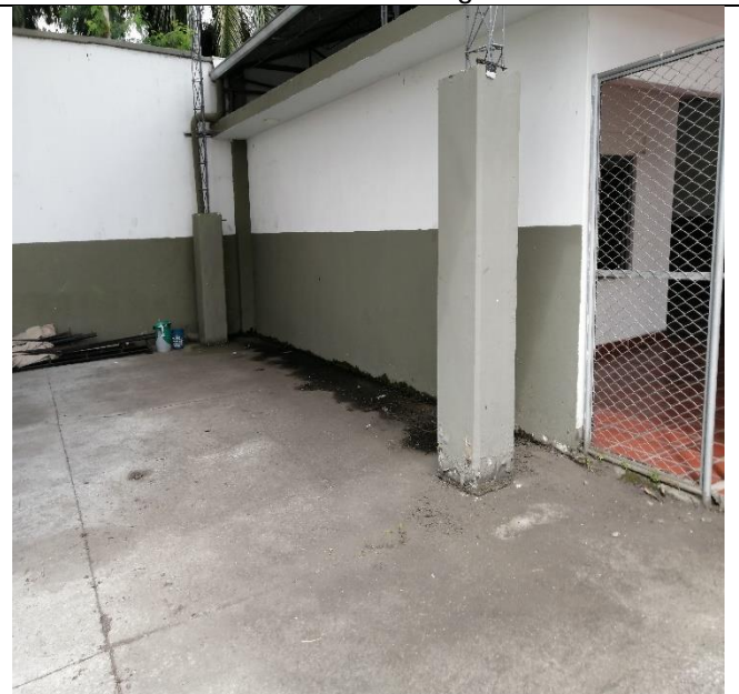
Camerinos sin mantenimiento, ni funcionamiento
