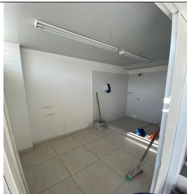
Estado de pisos y muros
