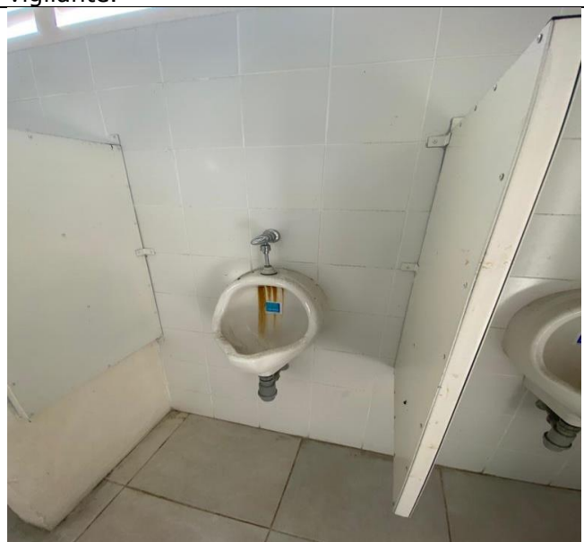
Deterioro en pisos, orinal, no se evidencia mantenimiento correctivo.
