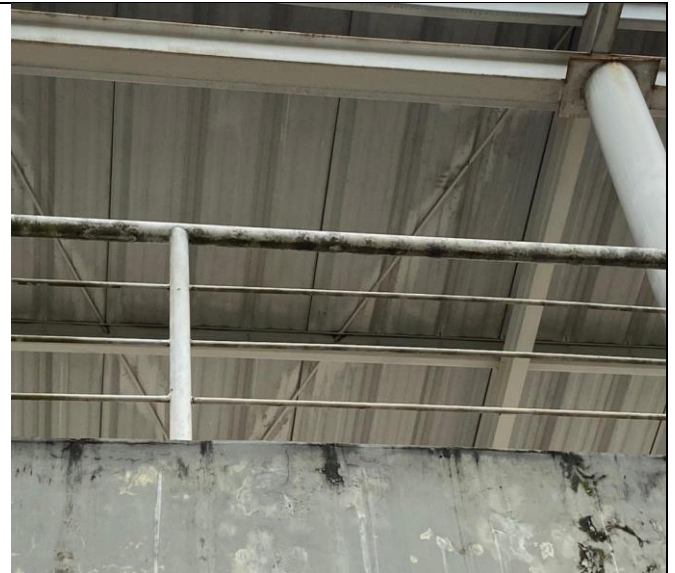
Deterioro marcado por las humedades, en losa, pisos y barandas.
