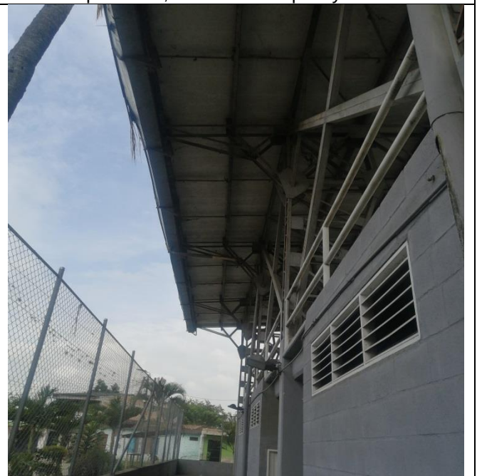
La canal del lado sur, todavía está instalada, pero con gran cantidad de desperfectos y huecos.
