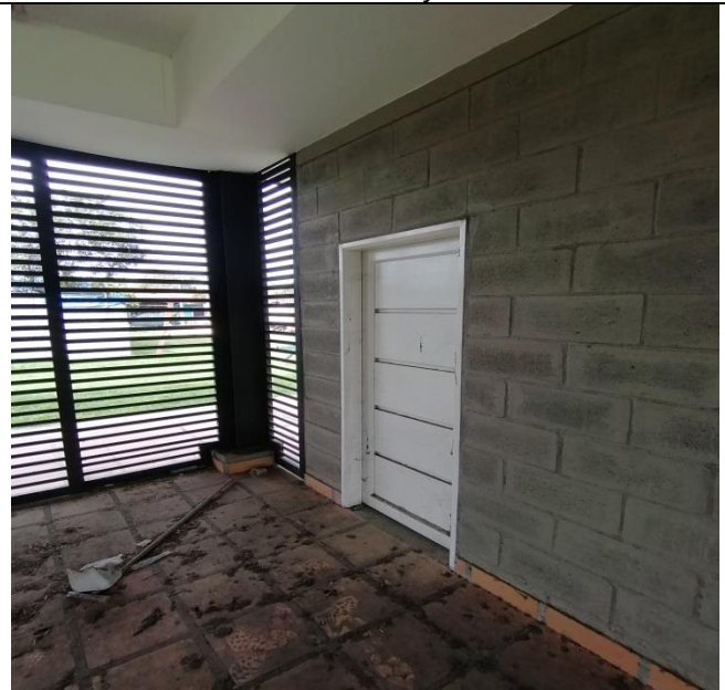
Deterioro en piso en tablón en el área de bodega
