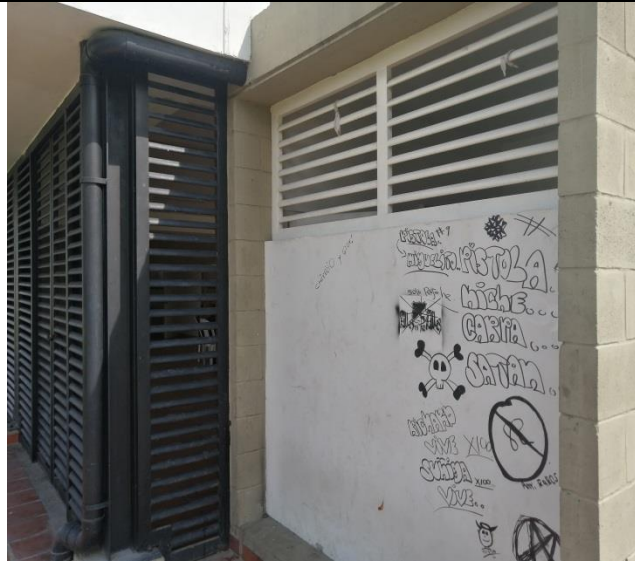
Fachada en bloque de cemento, deteriorada por vandalismo.
