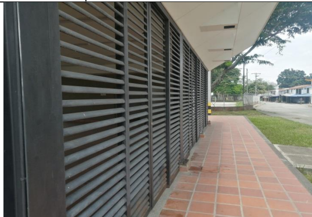
Piso exterior en tablón deteriorado y falto de mantenimiento.
