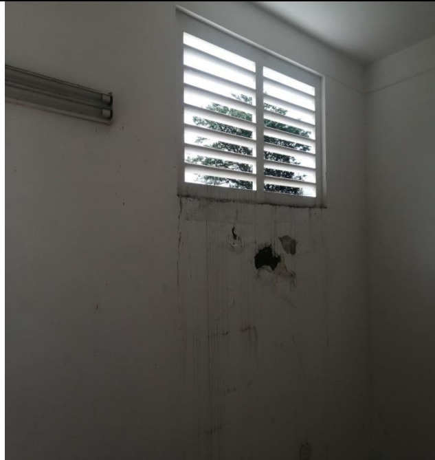
Estado de deterioro en muros, ocasionado por humedades.
