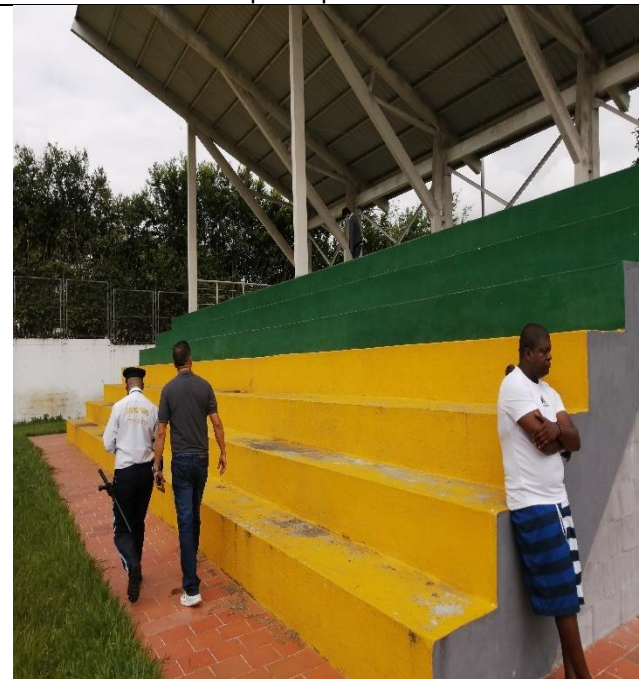
La junta de acción comunal se apropió del polideportivo, le hace el mantenimiento correctivo.
