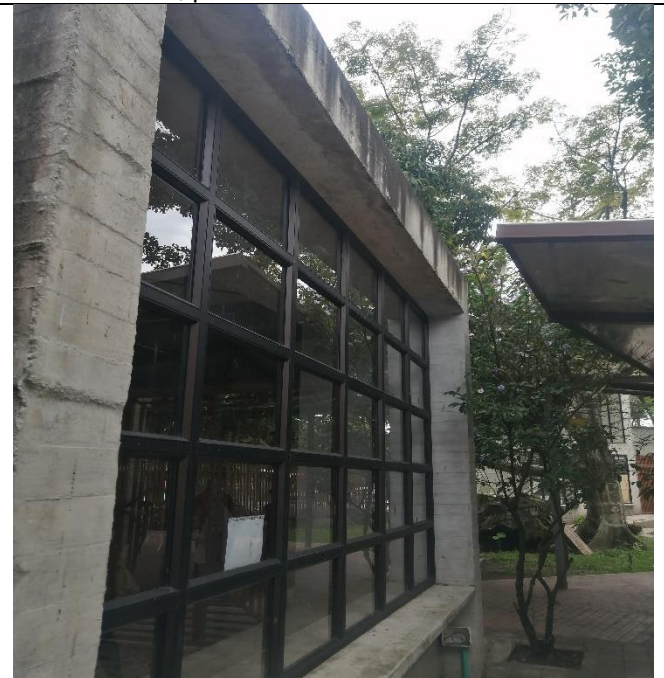
Deterioro por falta de mantenimiento en losas y canales,
