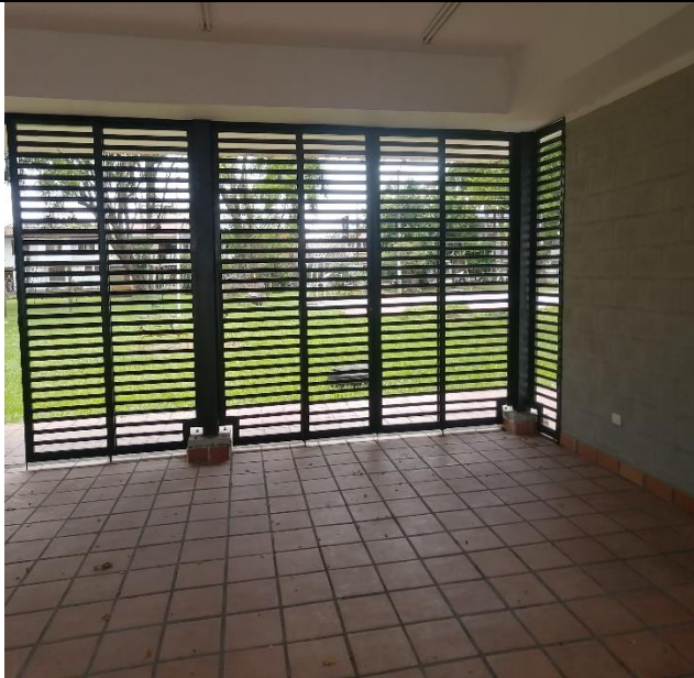
Se observa el poco mantenimiento que se le realiza al Equipamiento comunitario
