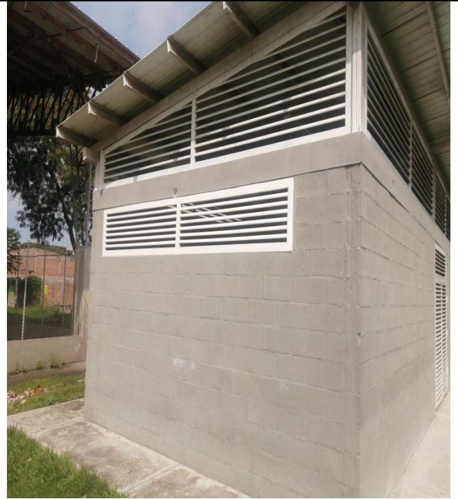
Cubierta corta lo que produce humedades y deterioro.
