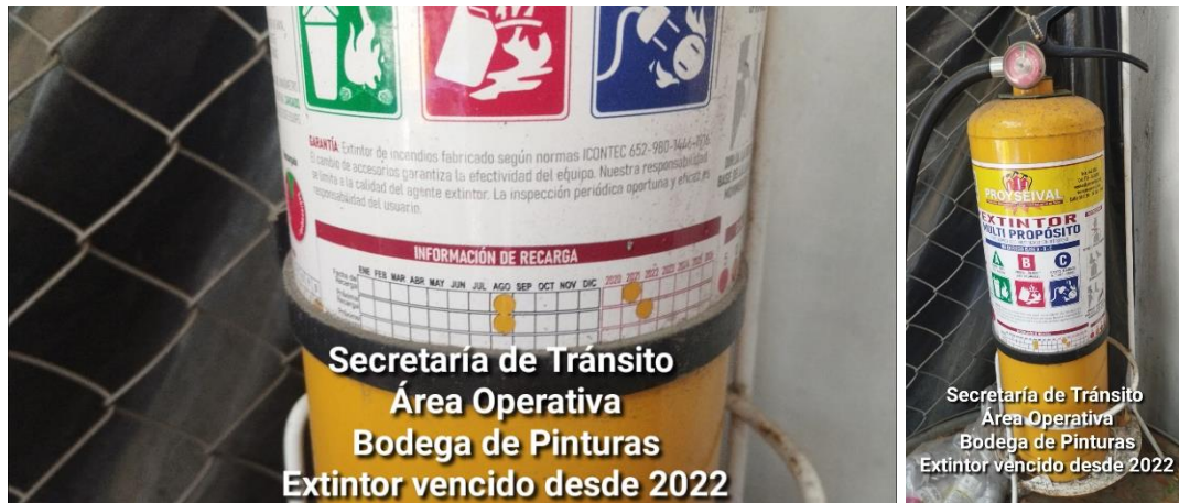
Se identificaron Extintores vencidos.
