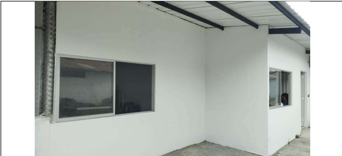
En la Oficina de Atención a víctimas se detectaron goteras por daños en el techo
